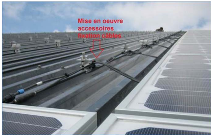
Figure 12 – Détails sur cheminement des câbles
