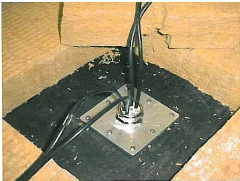
Figure 5 - Photos de la traversée de câbles
